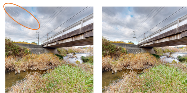
図-6 部材情報を活用したひび割れフィルタリング
